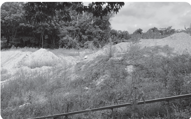
▲函南町内の不適切盛土現場
