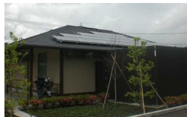
白糸の滝公衆トイレ太陽光発電設備
