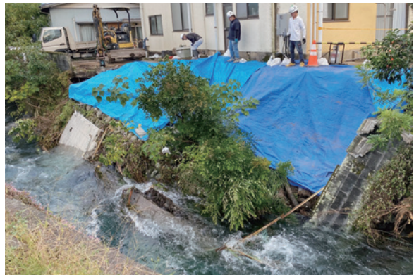
▲崩落した河川護岸の法面をシートで覆う(下川と潤井川の合流点付近)
